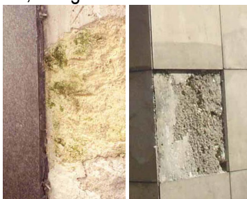
Opera Bastille - detalii ale degradărilor placajului (foto: Ana-Maria Dabija)
