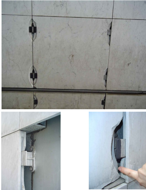
Marele Arc de la Defense - detalii ale degradărilor placajului (foto: Ana-Maria Dabija)
