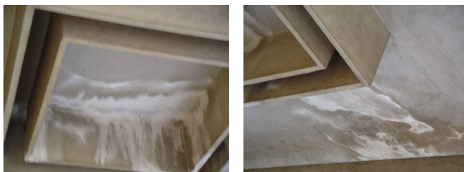
Intradosul unui portic; eflorescențele sunt ca urmare a deteriorării hidroizolației terasei de deasupra
