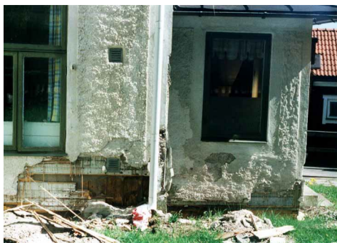
Degradări ale sistemului T.E.S.T., în zona soclului Foto Ana-Maria Dabija
