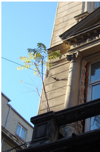
Copăcel crescut în crăpăturile din fațada unei clădiri istorice,
