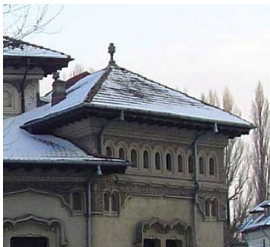
Detaliu de racordări curbe ale burlanelor la streășină la o clădire în stil neoromânesc, București Foto: Ana-Maria Dabija
