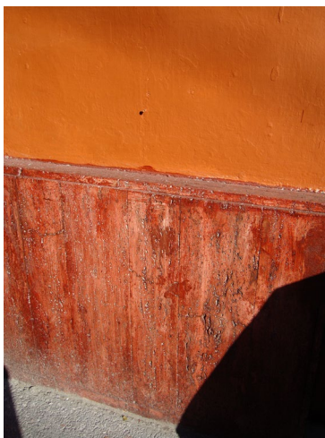
Placaj din travertin vopsit cu vopsea de ulei.
